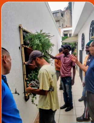
Instalação do Jardim Vertical na turma de jardinagem no Centro de Formação Heliópolis.
